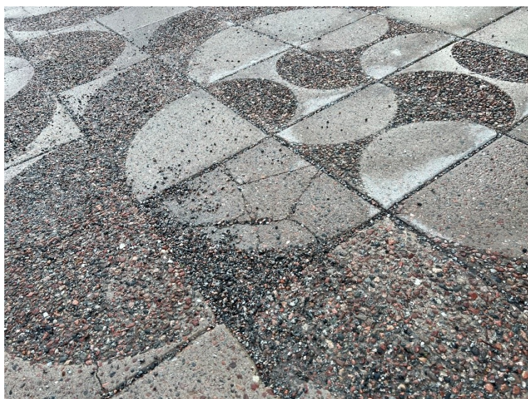
Figur 2.3. Skada på markbeläggning orsakad av obehörig trafik i centrala Tensta.
