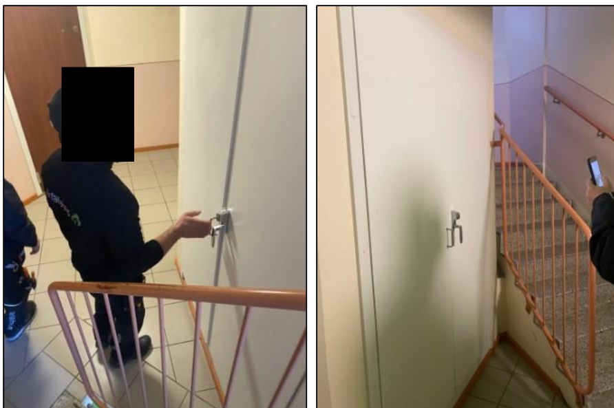
Figur 11. Dokumentation av felanmärkning av skåp.
