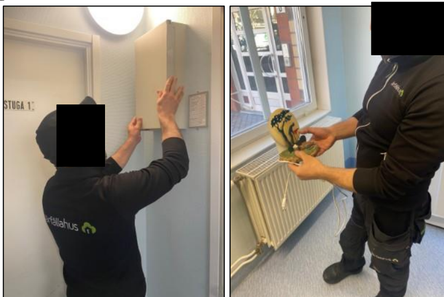
Figur 12. Anmärkning av skåp samt upphittat skräp i tvättstugan.
