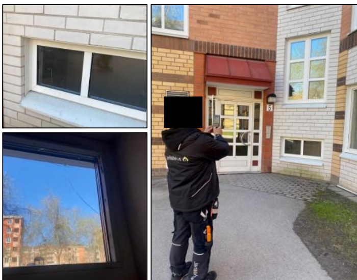
Figur 13. Dokumentation av trasigt fönster.
