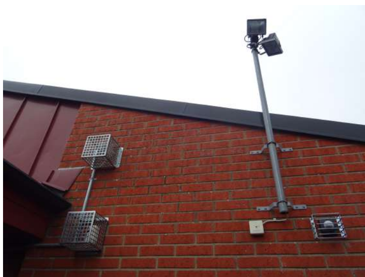
Kombination av mosquito-larm (t.v.), rörelsedetektor och spotlights (t.h.)
