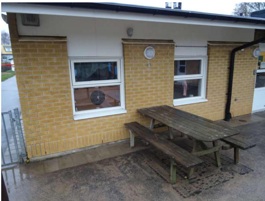
Bänkar nära fasaden skapar både brandrisk och ökad tillgänglighet till taket.
